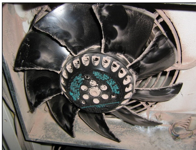
Se aprecia un ventilador con acumulación de polvo y de partículas suspendidas.
